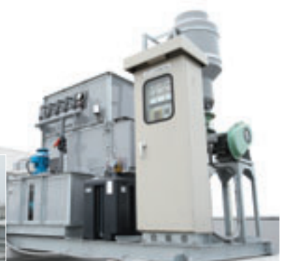
排ガス洗浄装置外観
